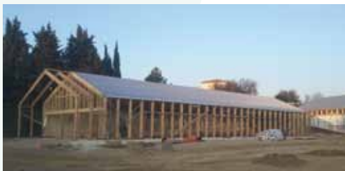
Figure 15 bis - Pôle œnotouristique de Saint-Christol - Architecte mandataire : Philippe Madec. BE Développement durable : TRIBU. Photo : TRIBU
